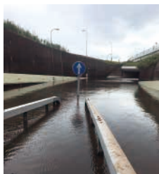
JCT 内冠水時の状況
